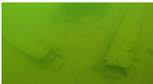
Figura 7. Registro do alicerce construtivo no Sítio Casa Grande. Notar a sedimentação sobre os alicerces. Data: 18/08/2016.
