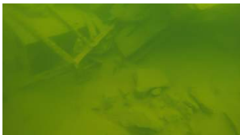
Figura 14. Registro de estruturas em metal classificado na Categoria 4. Data: 18/08/2016.
