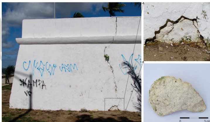
Figura 17. Não foi possível verificar as características físicas do sistema e dos materiais construtivos do Forte de São Francisco de Olinda, pois toda a sua muralha está rebocada. há apenas uma rachadura com exposição de argamassa em uma de suas fachadas.
