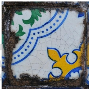
Figura 14. Contaminação – Processo deletério de alterações físico-químicas na chacota e vidrado pela proliferação de material orgânico patogênico, cloretos, nitritos, sulfatos.
