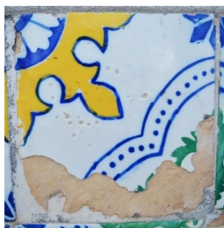
Figura 28. Furos – Área de vidrado delimitada com um poro, ilustrando o estado de degradação imediatamente anterior à queda do vidrado.
