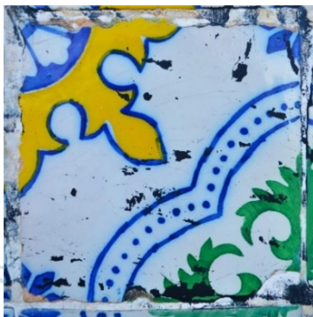
Figura 20. Manchas Superficiais – Sujidades superficiais, sem comprometimento do corpo cerâmico.
