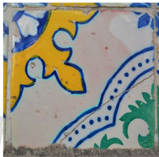
Figura 13. Alteração Cromática – Alteração da cor inicial dos azulejos ocasionada por reação química dos elementos constitutivos do azulejo ou dos vernizes de proteção.
