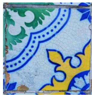
Figura 24. Fissura do Vidrado – Microfissuras da superfície esmaltada que se entrecruzam, geralmente, forma de teia de aranha ou craquelê .
