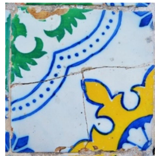
Figura 27. Trinca – Fissura no corpo cerâmico do azulejo, ou seja, uma ruptura das peças cerâmicas.
