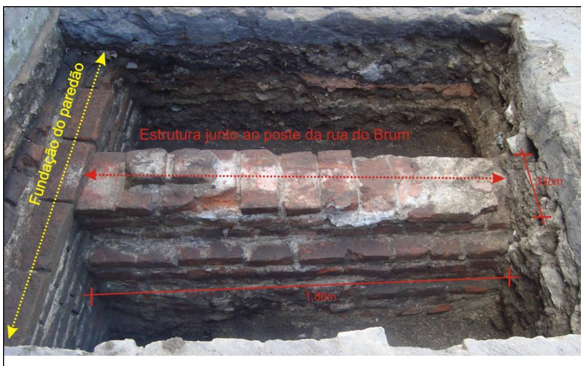
Figura 20: Estrutura junto ao poste da Celpe colada à fundação do paredão, mas sem amarração estrutural entre elas.
