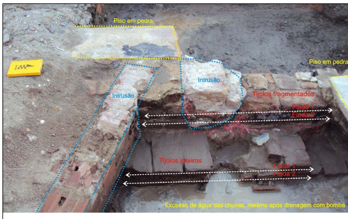
Figura 13: Detalhe do sistema construtivo. Fiadas em tijolo e rocha e excesso de argamassa entre as laterais.
