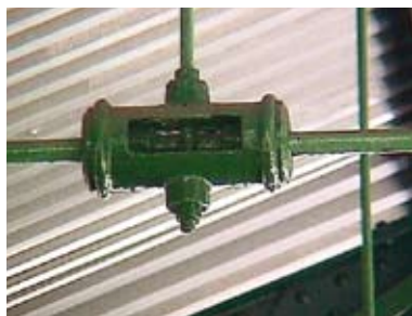
Figura 14: Elemento central e no qual, possivelmente, aplicou-se, durante a construção, uma carga diferencial de tração. Isto implica, portanto, em uma flambagem residual, conforme demonstrou-se no ensaio por elementos finitos. Trata-se do único nó com restrição de movimentação (rotação no plano da treliça em X e Y) e que, conforme a hipótese de cálculo e devido a tração diferencial causou a flambagem visível.
