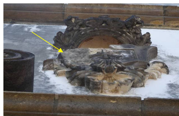
Figura 12. Lacunas e perda de seção em cantaria (Brasão da Sta. Casa da Misericórdia). Fonte: acervo próprio (2022).
