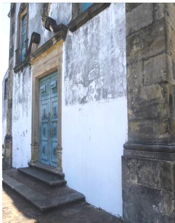
Figura 5. Fachada com caiação parcial.
