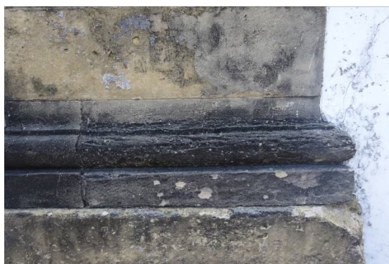
Figura 9. Descamação e perda de seção no embasamento dos pilares. Fonte: acervo próprio (2022).
