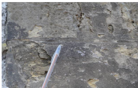
Figura 10. Pitting e desagregação granular nos pilares de rocha arenítica. Fonte: acervo próprio (2022).
