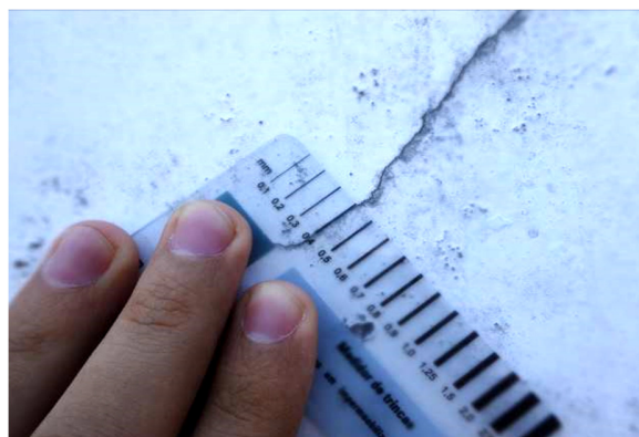
Figura 8. Medida da abertura da fissura com fisurômetro. Fonte: acervo próprio (2022).
