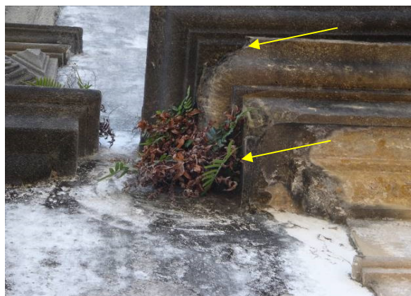
Figura 14. Vegetação e perda de seção (lacunas) na cantaria. Fonte: acervo próprio (2022).
