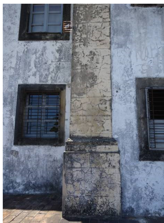
Figura 6. Fissuras aleatórias no pilar central (cantaria).
