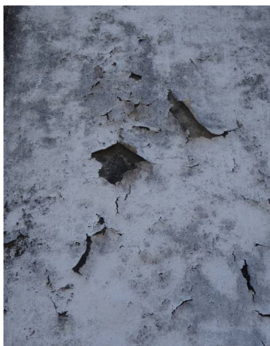
Figura 15. Descolamento da camada de pintura. Fonte: acervo próprio (2022).
