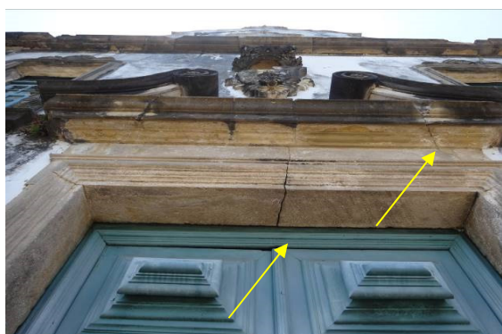
Figura 11. Fendas e sujidades na cercadura da entrada principal. Fonte: acervo próprio (2022).
