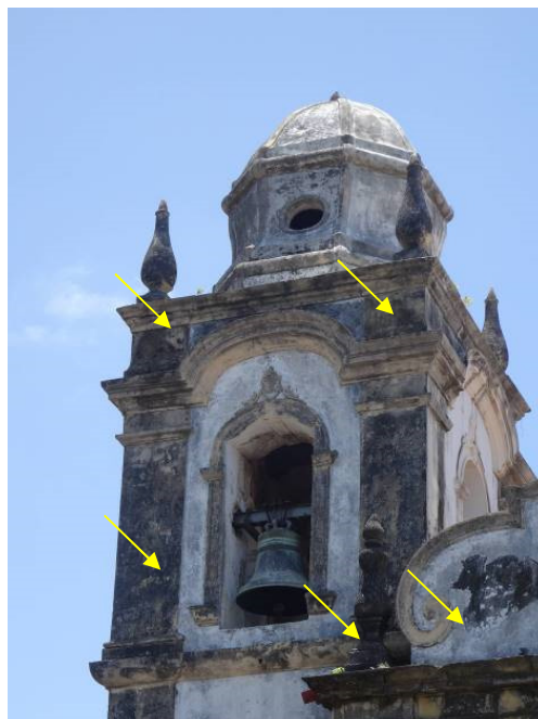
Figura 4. Coruchéu, pináculos e cantarias com sujeidades.
