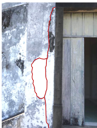
Figura 7. Fissura vertical e descolamento do reboco. Fonte: acervo próprio (2022).
