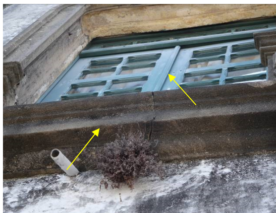
Figura 13. Fissuras e vegetação na cercadura da janela. Fonte: acervo próprio (2022).
