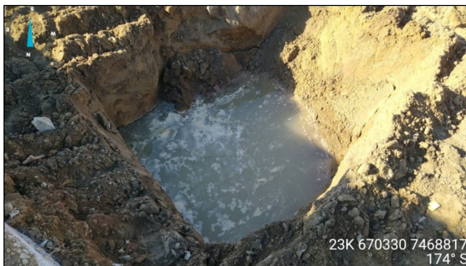
Figura 6. Buraco cheio de água.
