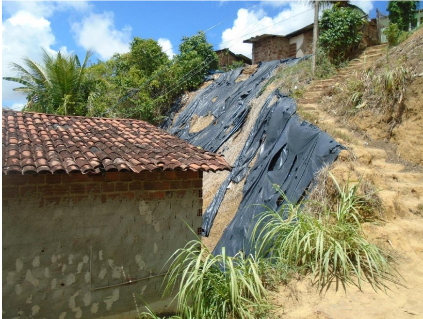
Figura 5 – Registro fotográfico do setor, evidenciando a ocupação desordenada na encosta, por uma moradia de baixo padrão construtivo, através de corte inadequado para sua segurança - Exemplo: Exemplo: Setor.
