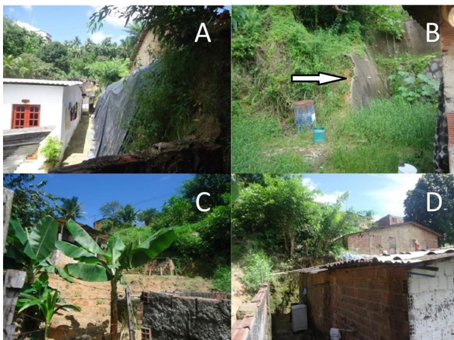
Figura 8 – Registro fotográfico do setor PE-OL-SR-02. A) moradia próxima ao talude de corte com declividade acentuada, protegida por uma lona plástica, evidenciando que já houve um movimento de massa. B) rachadura no muro de contenção evidenciado pela cicatriz de deslizamento. C) Solo exposto com plantio de bananeiras, podendo resultar no acúmulo de grandes quantidades de água. D) proximidade da moradia ao talude de corte contribuindo para o consequente aumento no grau de vulnerabilidade - Exemplo: Setor.
