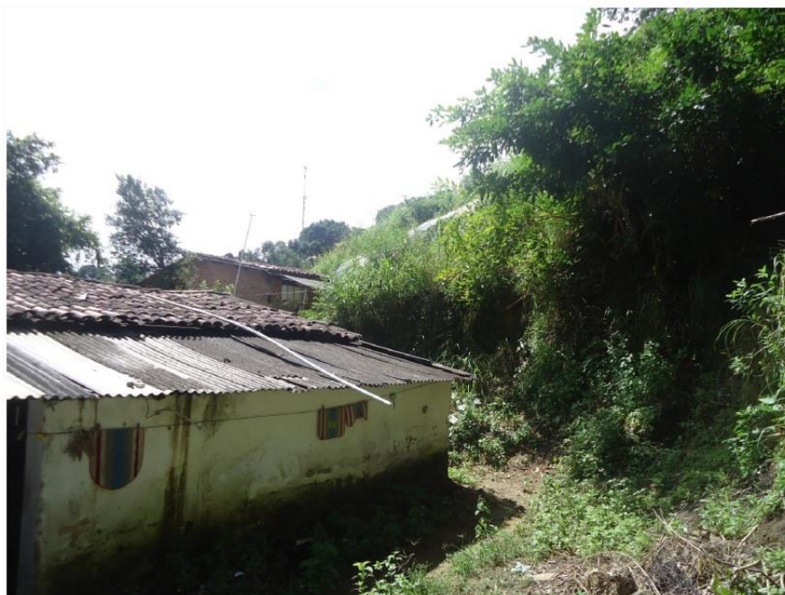
Figura 7 – Registro fotográfico geral do setor PE-OL-SR-02, evidenciando a ocupação desordenada na encosta, por uma moradia de baixo padrão construtivo, através de cortes do tipo gaveta - Exemplo: Setor.
