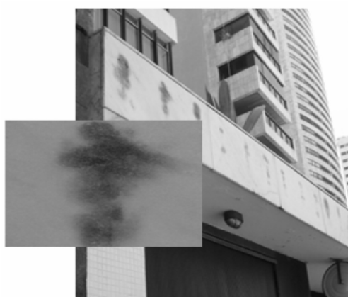
Figura 6 - Oxidação na superfície das placas (Inserts)
