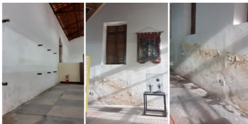
Figura 3: Problemas de conservação do Museu Memorial de Caruaru.
