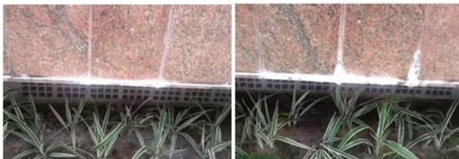
Figura 5 - Eflorescência - Edifício Burle Marx
