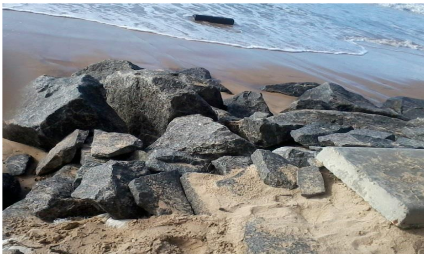
Figura 8. Vista do muro de contenção e avanço do mar em 2012.
