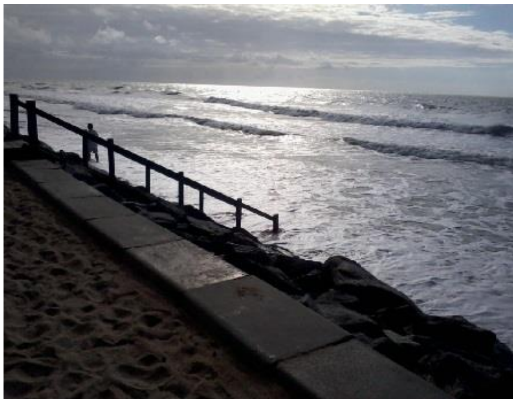
Figura 7. Desgaste do muro de contenção devido ao avanço do mar no ano de 2012.
