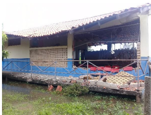
Imagem 4: Uma parte do pavilhão da escola que caiu
