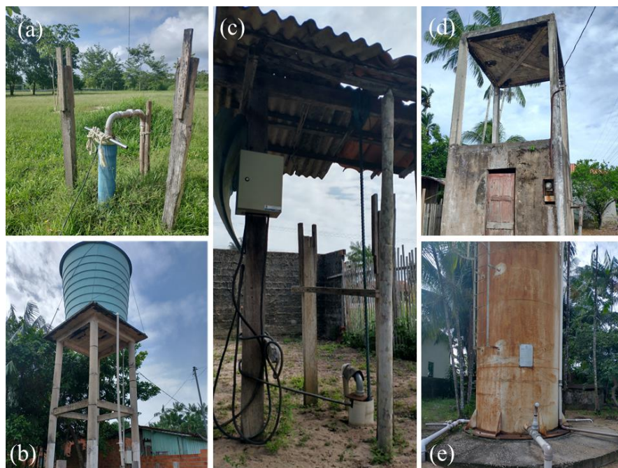
Figura 3. Captação, distribuição e reservação de água: Bairro do Palmeiras (a), Bairro Aviação (b), Bairro Novo (c), Bairro Novo (d), e Bairro da Igreja (e) do sistema de abastecimento de água da comunidade São Francisco de Irituia, Irituia - PA.
