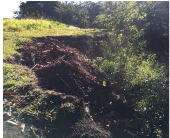
Figura 8A – Erosão na margem do córrego Alecrim
