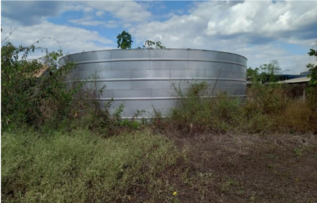
Figura 5. Estação de tratamento de esgoto sanitário inacabada, localizada no final da Avenida Couto Magalhães esquina com a rua Contorno no bairro da Olaria Norte em Conceição do Araguaia
