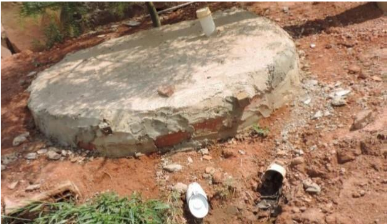
Figura 4. Fossa rústica utilizada para tratamento do esgoto sanitário em Conceição do Araguaia.
