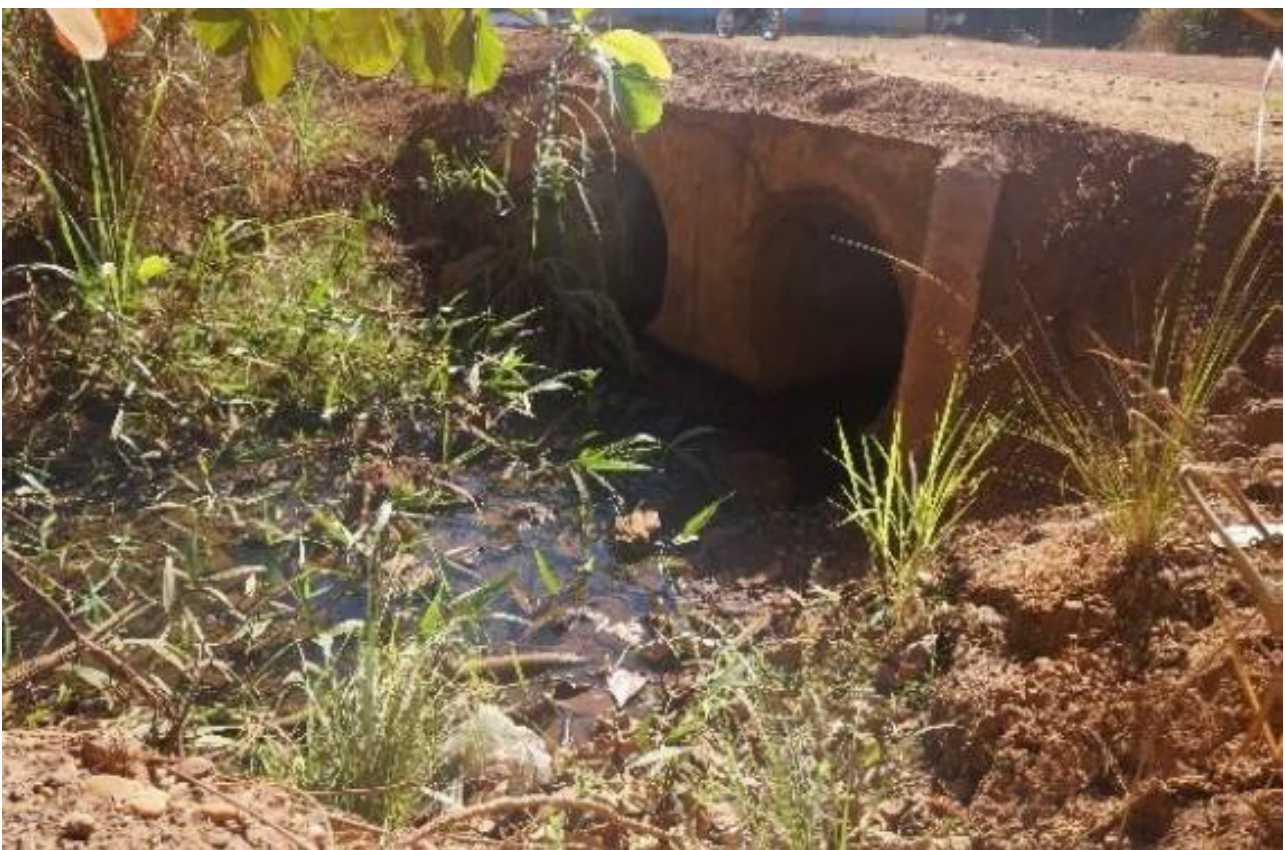
Figura 9. Bueiro instalado no córrego Emerêncio em Conceição do Araguaia, o que ocasionou o aterramento do córrego e a diminuição das suas águas.
