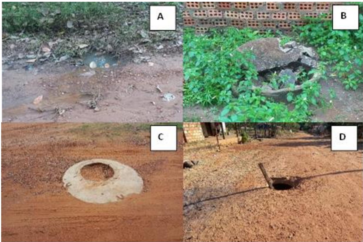
Figura 6. Poço de visita sem a tampa de concreto (A), poço de visita com tampa quebrada (B), bueiro central sem a tampa de ferro (C) e bueiro completamente aberta (D) no centro da rua 7 de setembro bairro do Setor Universitário em Conceição do Araguaia.
