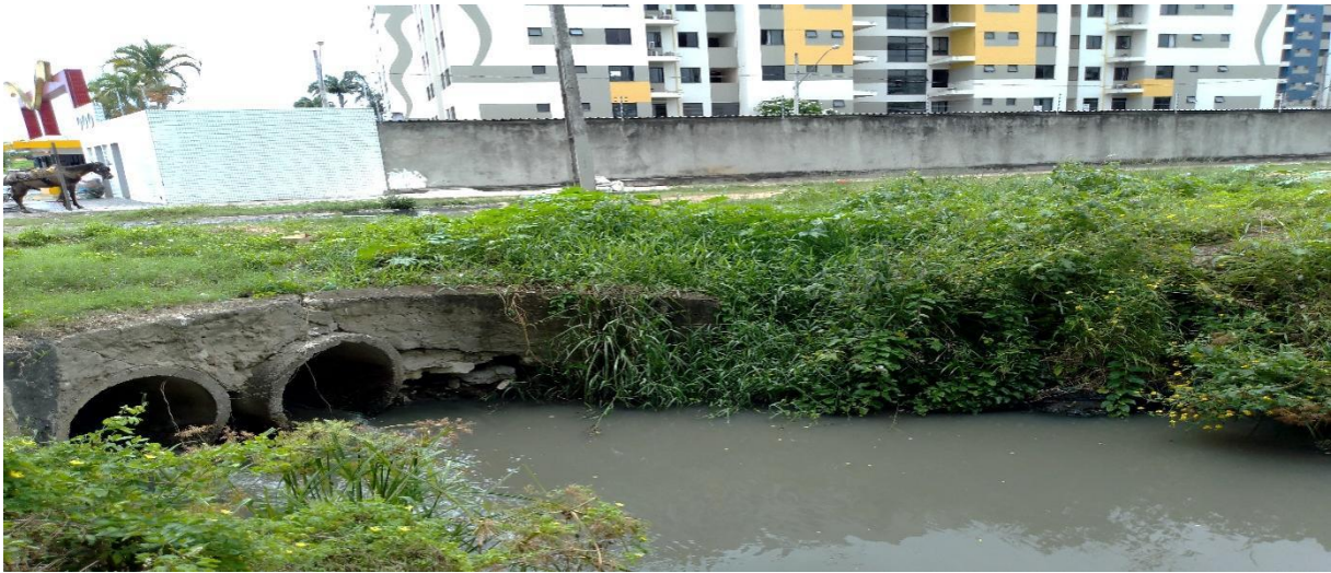
Figura 4. Imagem de despejo de esgoto no rio Poxim próximo ao Condomínio Clube Bossa Nova no bairro Jabotiana, Aracaju/SE.
