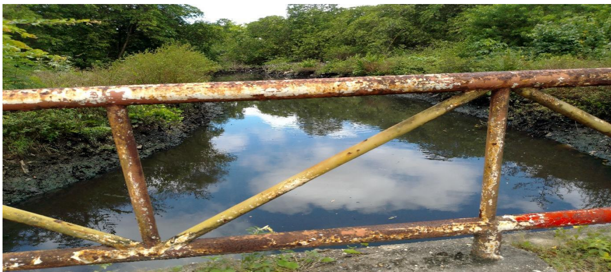
Figura 11. Imagem retirada do Canal situado no conjunto Santa Lúcia com despejo de efluentes no rio Poxim.
