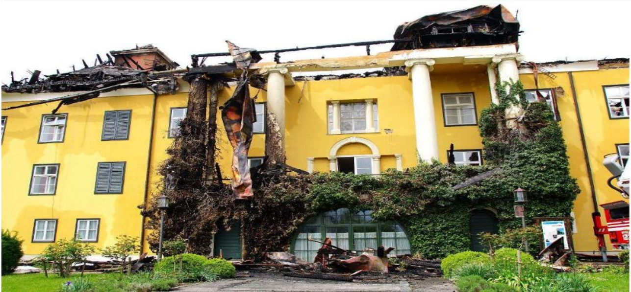
Figura 3. Incêndio em fachada verde do Castelo Ebenzweier em Altmünster, Áustria. Fonte: Sommer (2016).
