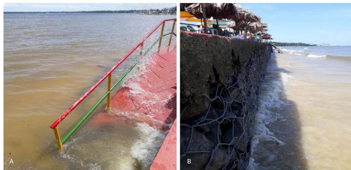
Figura 6. Ilustrações do efeito da maré alta nos meios de passagem de pedestres à praia (A) e no muro de gabião (B). Fonte: Registro feito pelos autores.
