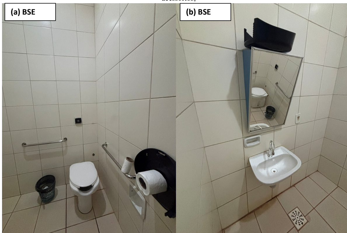
Figura 06 - Sanitário acessível com inadequações gerais; Vaso sanitário com abertura frontal e barras e acessórios instalados fora do padrão (a); Lavatório com torneira fora do padrão, sem barras de apoio e sem os acessórios;
