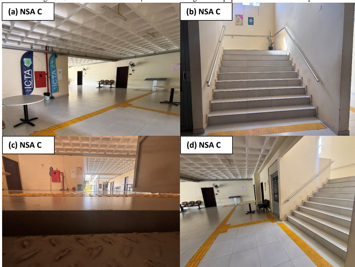
Figura 13 - Ausência de sinalização de rota de fuga e de equipamentos de incêndio e pânico
