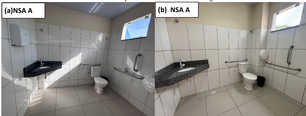
Figura 07 - Barras de apoio instaladas incorretamente e a da vertical em comprimento fora de norma, acessórios instalados fora da norma e alguns ausentes, torneira não acessível, vaso sanitário fora da altura normatizada e caixa acoplada com acionador da descarga
