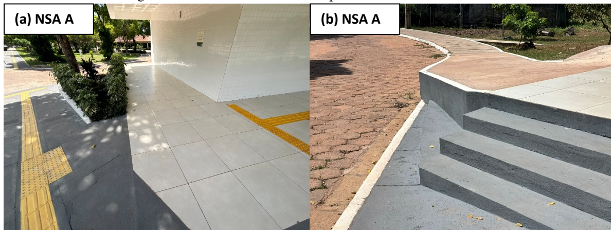
Figura 09 - Falta de continuidade do piso tátil na rota externa/interna
