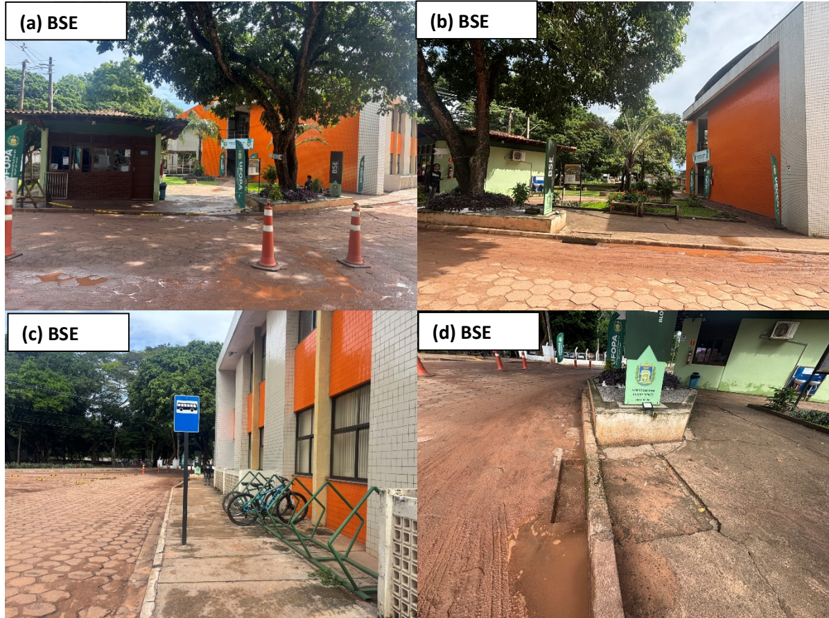
Figura 1 - (a/b) Entrada do BSE com canteiros, trechos de piso desnivelado; (c) lateral com bicicletário e placas de sinalização reduzindo a faixa livre; (d) guia meio-fio sem rebaixo, tampa de caixa desnivelada do piso;
