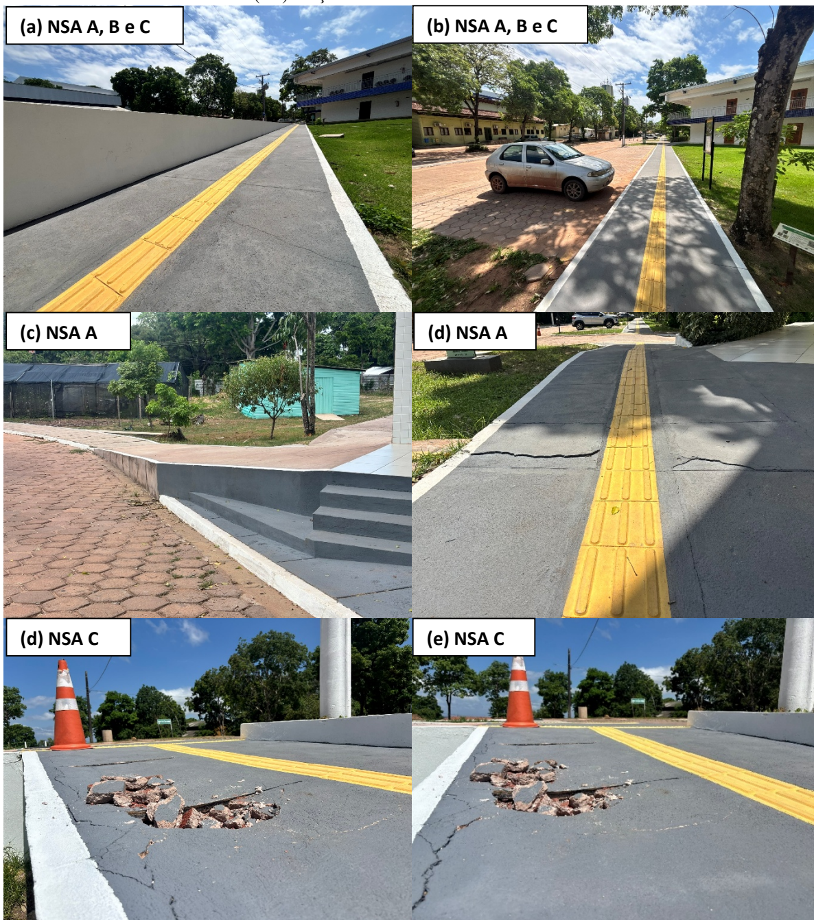
Figura 02 - (a/b) Calçada frontal do Núcleo de Salas de Aula A, B e C – trecho em excelente condições; (b/c) Calçada frontal do Núcleo de Salas de Aula A – inclinação fora do permitido e trecho de calçada com desnível; (d/e) Calçada de acesso ao Núcleo de Salas d
