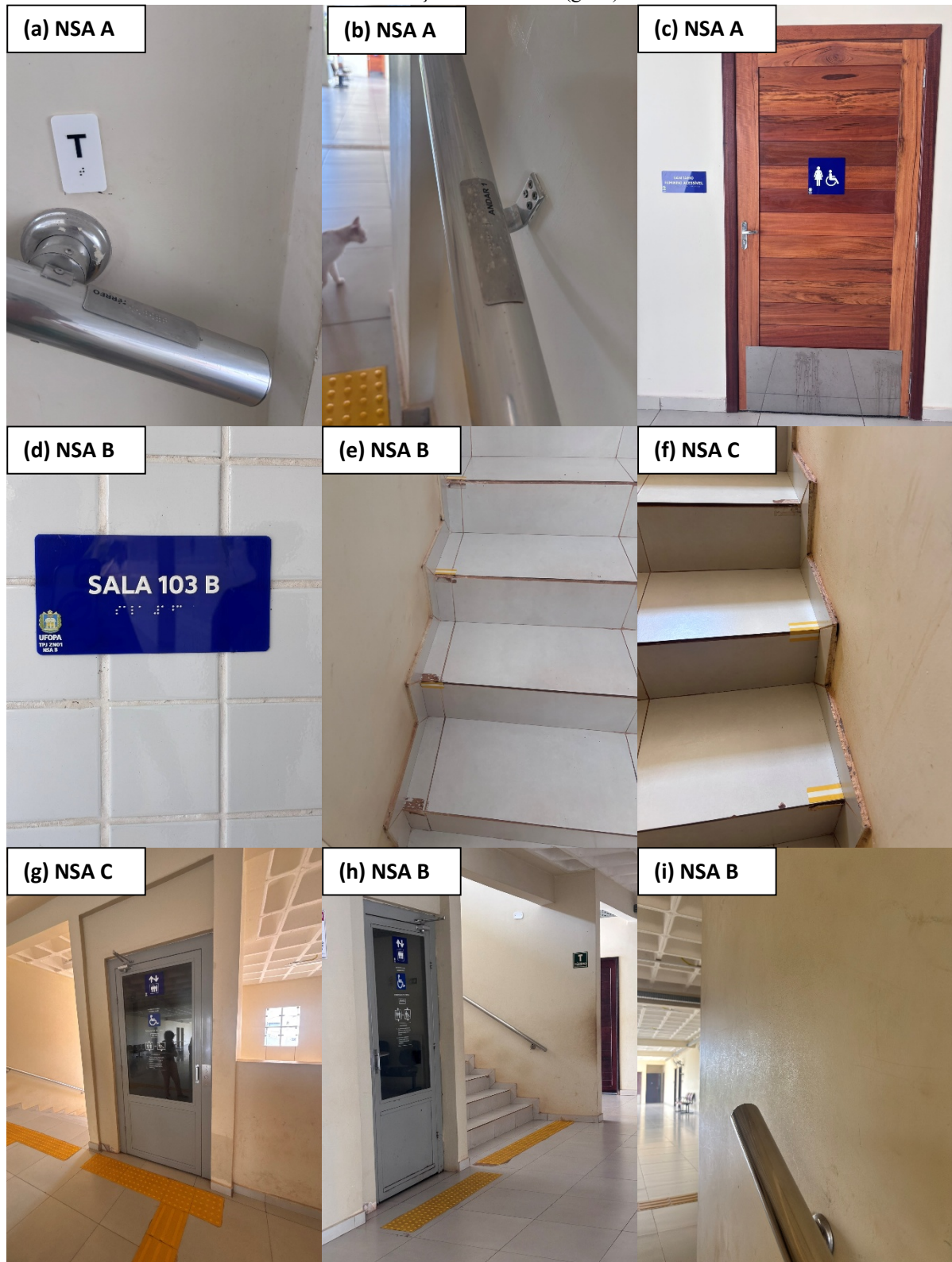
Figura 11 - Sinalização tátil e visual instalada no corrimão e na parede (a-b); placa tátil com relevo e em braile (c-d); sinalização fotoluminescente de degraus desgastada (e-f); batente de plataforma e corrimão sem sinalização tátil e visual (g-h-i)
