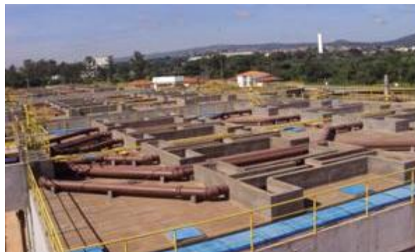
Figura 7. Estação de Tratamento de Esgoto.
