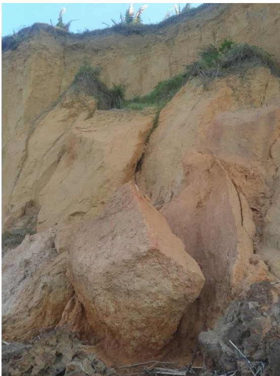
Figura 11. Fotografia mostrando queda de blocos na falésia de Itapari. Fonte: Fotografia dos autores, 2016.
