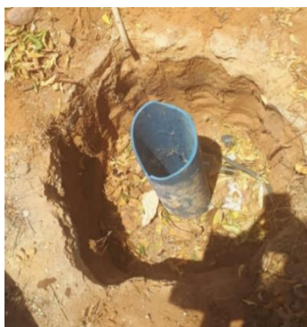
Figura 7. Poço nº 11 sem proteção aumentando os riscos de contaminação do aquífero
