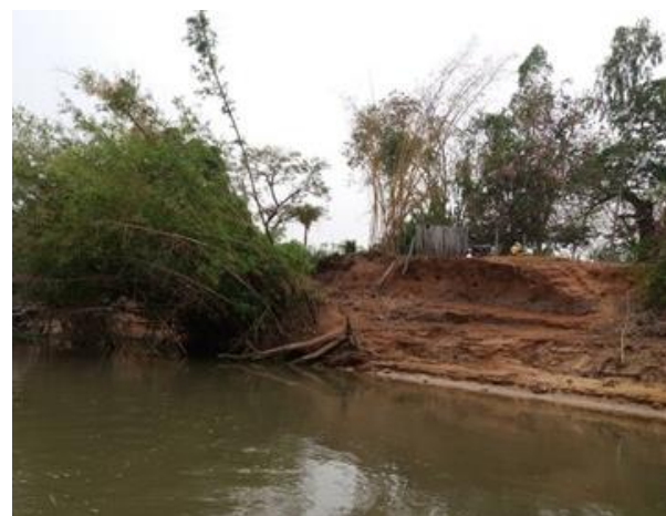
Figura 6: Desmoronamento da margem com queda de Bambusa tuldoidea Munro (Bambu taquara) no Ponto Crítico 11. Fonte: Autores.
