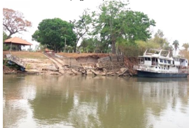
Figura 5: Restos do muro de arrimo construído nas proximidades do Ponto Crítico 11. Fonte: Autores.
