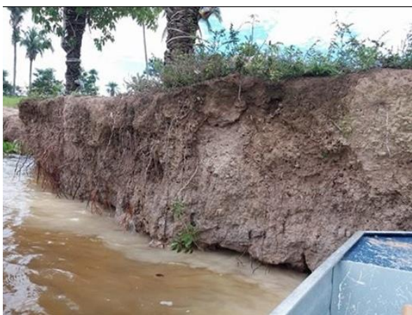
Figura 7: Erosão por solapamento basal no Ponto Crítico 12. Fonte: Autores.
