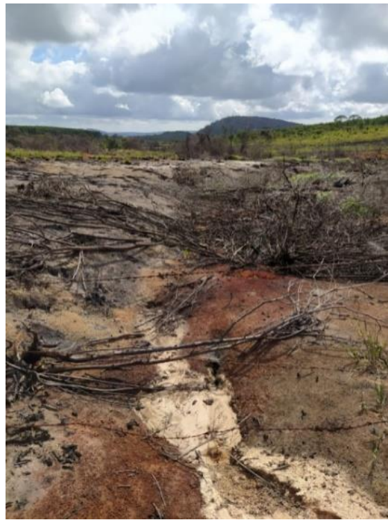
Figura 6. NV 11 - Nascente do Rio do Padre - Ausência de vegetação e evidência de processo erosivo a Montante da nascente
