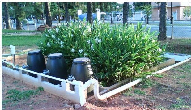
Figura 04: ETE por TS+WC. Fonte: IFG, 2015.
