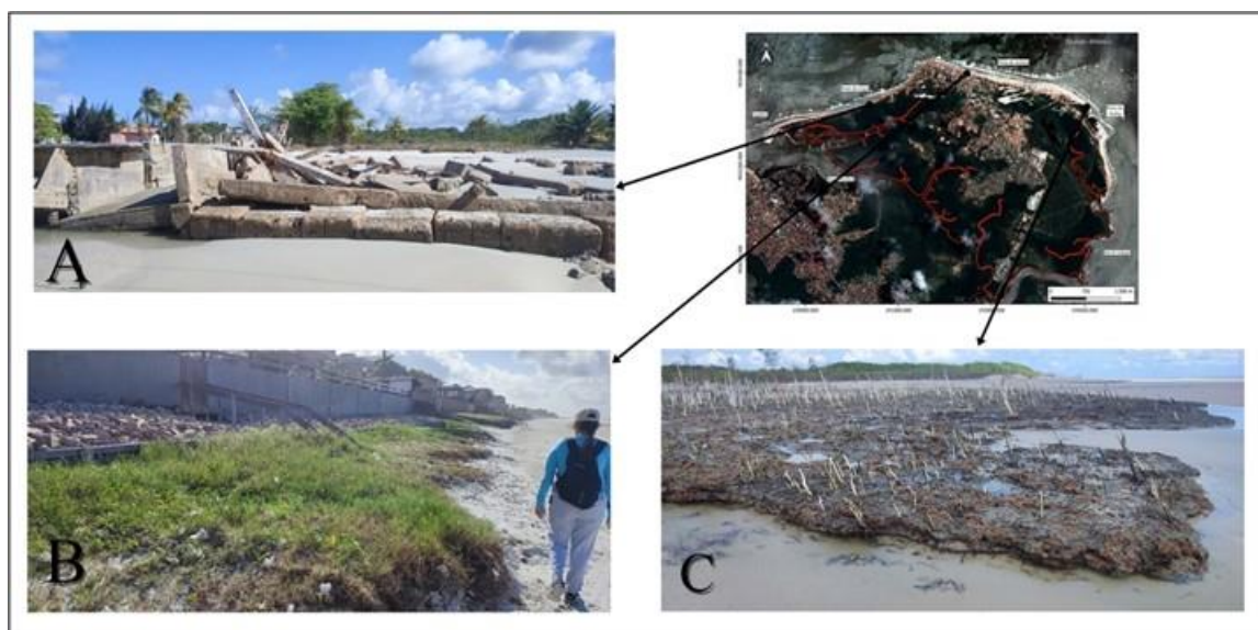
Figura 7. Indicadores de erosão nos setores da ilha de Atalaia. A) Área central do setor A (praia do farol) com construções danificadas pela erosão presente na área. B) Setor B (praia de Atalaia) com presença de estruturas de contenção à erosão. C) Setor C (praia da Sofia) com presença de “Paleomangue”, feição essa condizente com as características erosivas desta área específica
