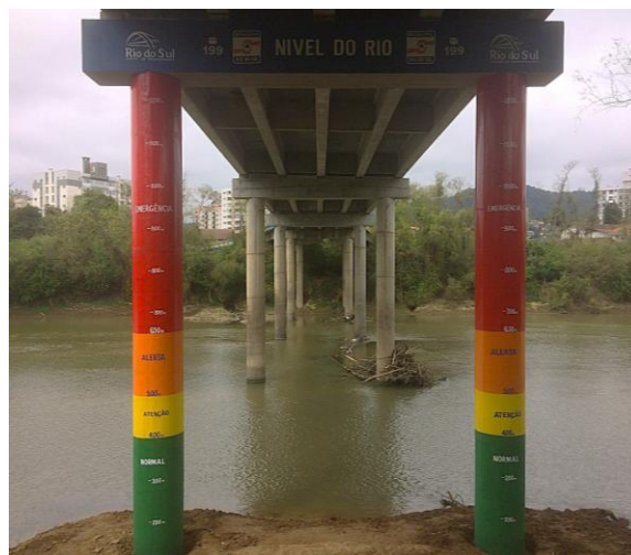
Figura 3 – Monitoramento das cotas de inundação na ponte Tito Buss em Rio do Sul 18
