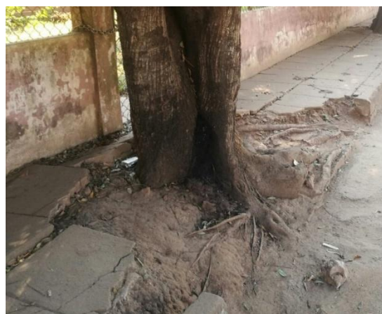
Figura 8 - Sistema radicular de Senna Siamea destruindo passeio nas ruas do Município de Chimoio. Fontes autores (2024)
