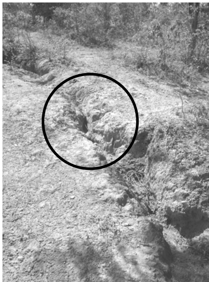
Figura 8: Pipings formados a partir da drenagem subsuperficial.
