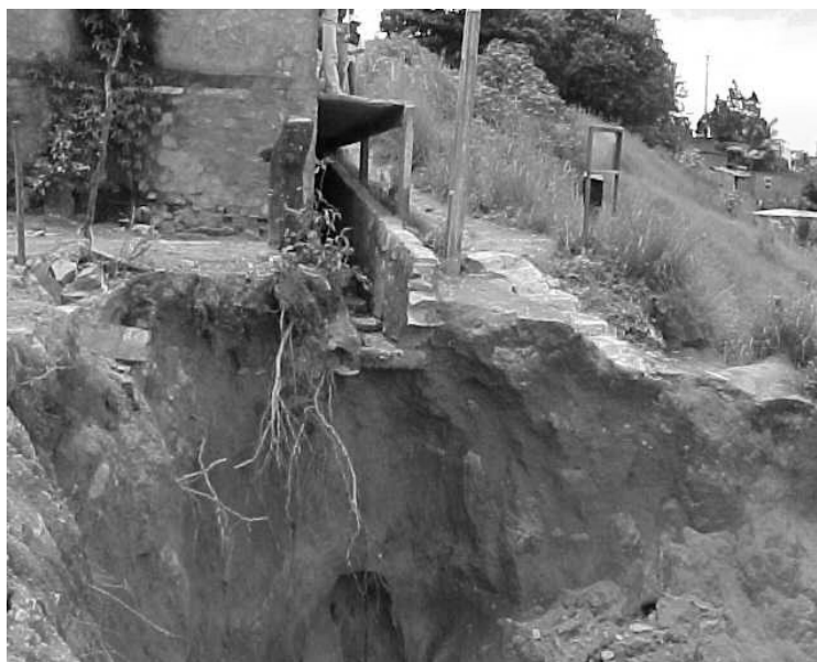
Figura 2. Rompimento de canaleta de despejo de esgoto no topo da voçoroca da Rua Camanducaia, UR-02 – bairro do Ibura, sudoeste do Recife (Foto da Comissão de Defesa Civil do Recife – CODECIR – 04/2004).
