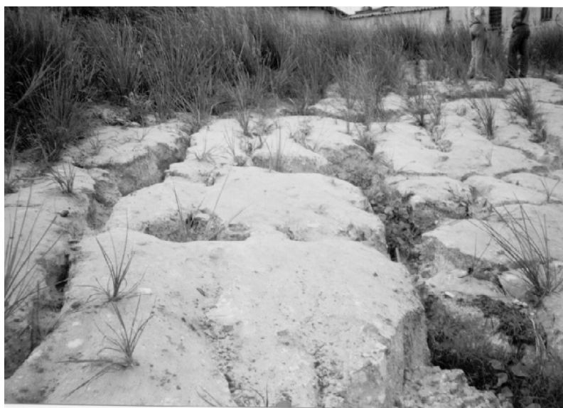
Figura 4. Cerca de um ano após a colocação do aterro na encosta da Rua Camanducaia observa-se o desenvolvimento de inúmeras ravinas, com indícios de infiltração no “pacote” deposicional, devido a não compactação, além da incipiente cobertura vegetal remanescente do plantio (Foto de Osvaldo Girão - 09//09/2004).
