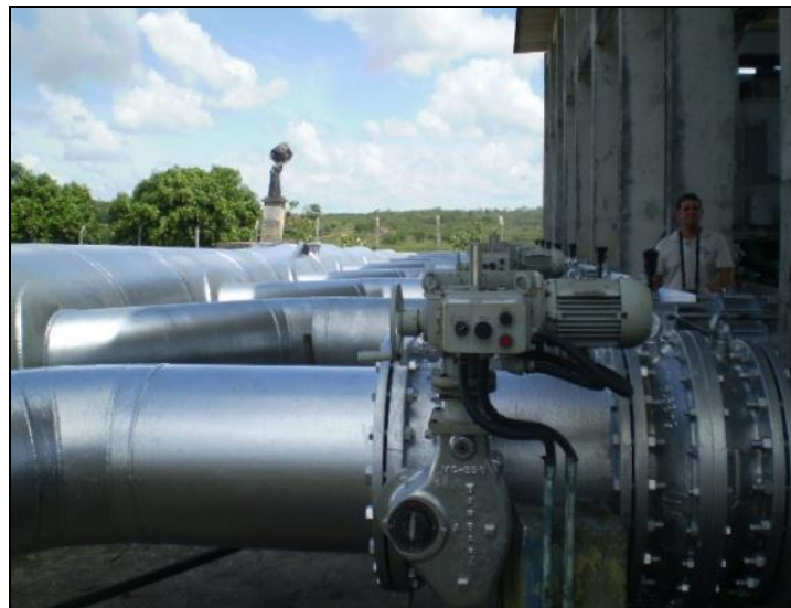
Figura 2 – Rede de Bombeamento de água em Neópolis/SE.
