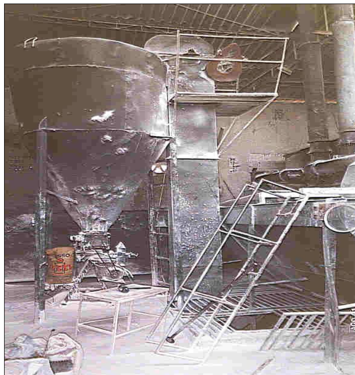
Figura 5 – Parte de forno rotativo da Ingel, Indústrias de Gesso Ltda. Município de Trindade. Observam-se o silo de ensacamento, o elevador, a balança e dois exaustores. Foto Sérgio Araújo (2001).
