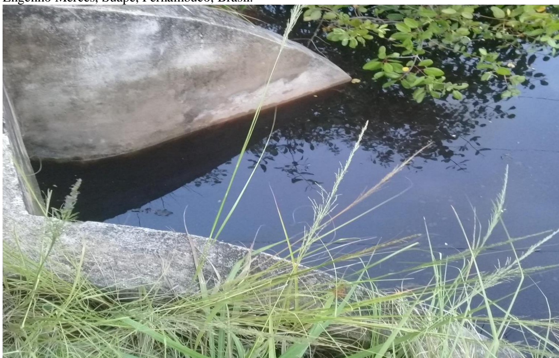
Figura 4: Duto de drenagem dos efluentes da Refinaria Abreu e Lima no entorno da comunidade de Engenho Mercês, Suape, Pernambuco, Brasil.
