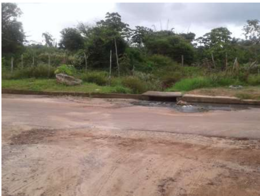
Figura 5: Esgoto estourado no residencial Amendoeiras
