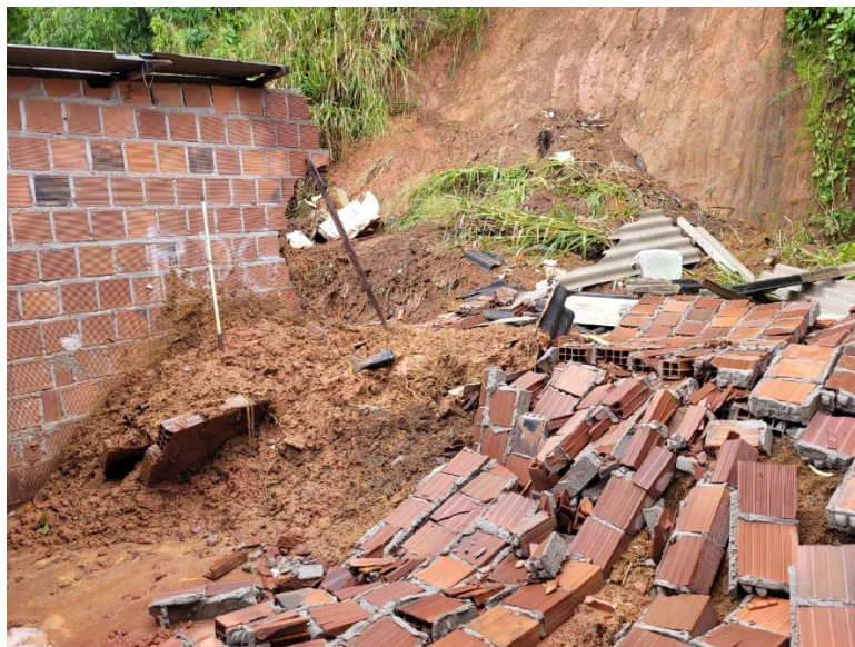
Figura 5 – Nova Descoberta/ Recife - Deslizamento de terra em encosta - 2022
