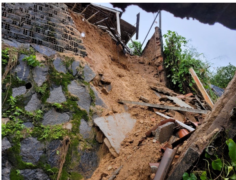
Figura 4 – Nova Descoberta/Recife - Deslizamento de terra em residência devido a fortes chuvas - 2022
