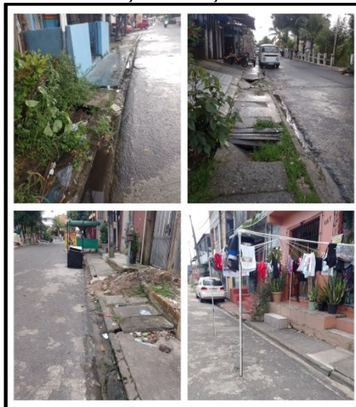
Figura 15 – Bairro da Pedreira – Situação das calçadas na Av. Visconde de Inhaúma – 2022
