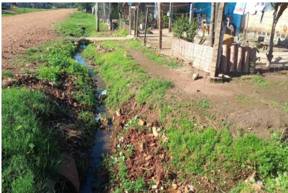
Figura 03 – Escoamento pluvial e ligações de esgoto, vila Mario Roque Weis, bairro do Passo
